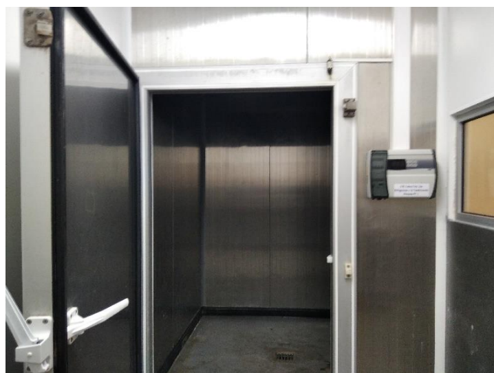
Espaço interior - Câmara Frigorífica
