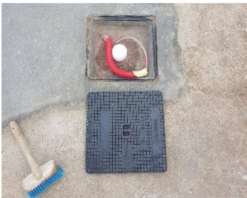
Figura 9 – Exemplo de um nicho de proteção de furo de sondagem onde foi colocada calha inclinométrica (FSM2; Fig. 11).
