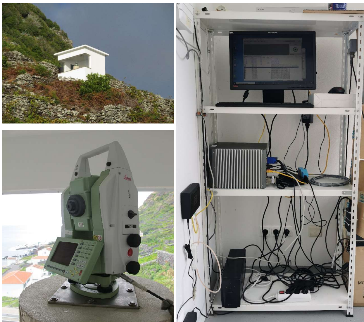
Figura 6 – Aspeto geral do ponto estação da rede de monitorização geodésica instalado no abrigo da Maia e dos restantes equipamentos de alimentação, controle e armazenamento de dados.
